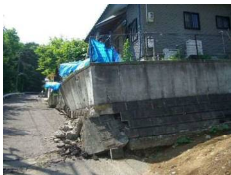
大規模盛土造成地の滑動崩落例
